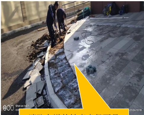
消防车道的转弯半径不足
