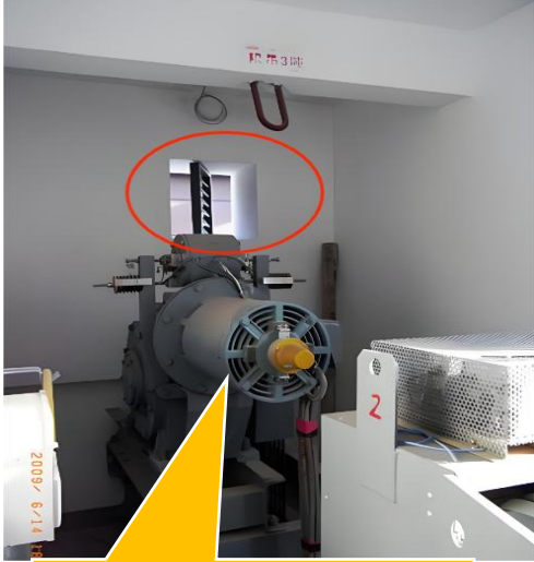
消防电梯机房在隔墙上有洞口
